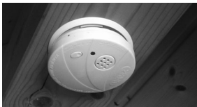
Ein installierter Rauchmelder
